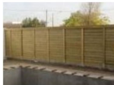
Barrière de protection pleine
